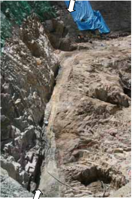
写真 F-1断層 （ダム軸側から堤趾方向を撮影） 上下流に堤敷き内を横断する。 F-1断層は減勢工下流側まで連続する。
