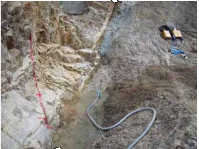
写真 F-1断層 （堤体下流付近） 全体に変質を伴い、断層内部は、固結した礫混じり粘土を主体とする。
