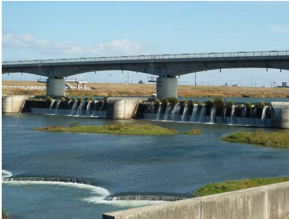
神戸堰倒伏状況（平成27年11月12日）
