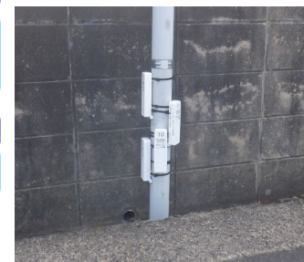
浸水センサ設置状況
