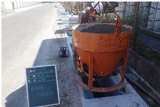
八幡町雨水渠
