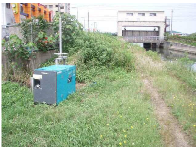
○仮設排水ポンプ
