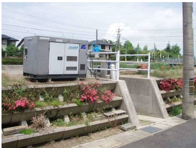
○仮設排水ポンプ（道路側より）
