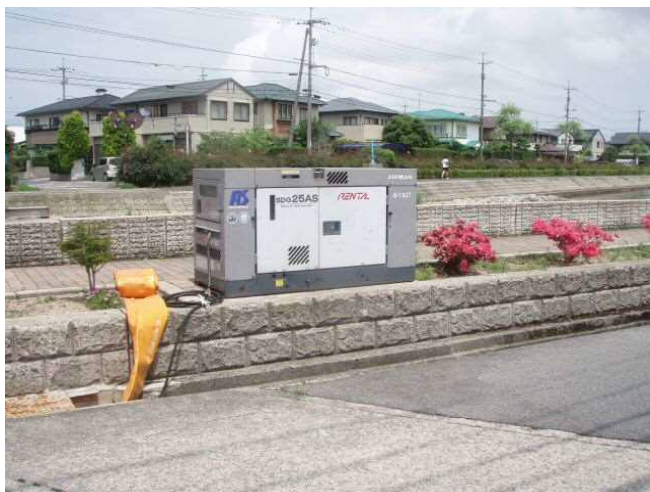
○仮設排水ポンプ（道路側より）
