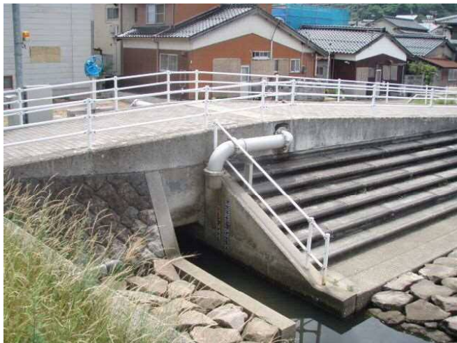
○ポンプ（承水路側から見て）
