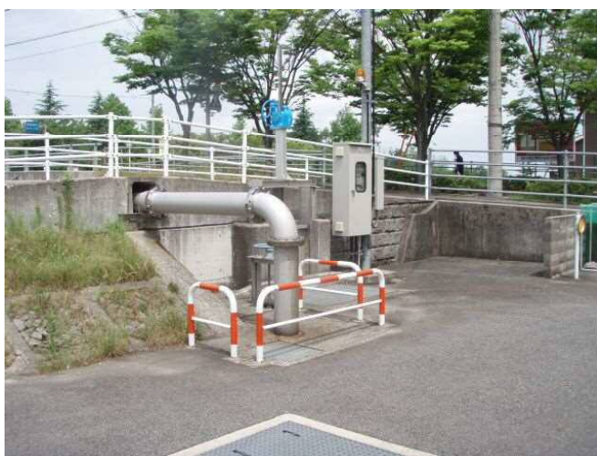
○ポンプ（道路側から見て）
