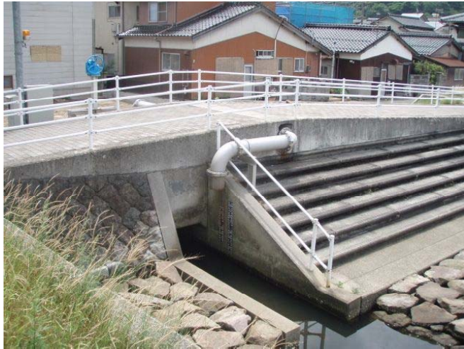
○ポンプ（承水路側から見て）
