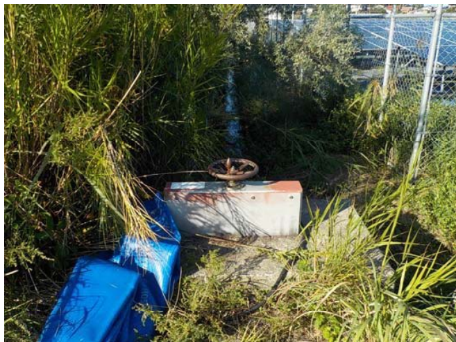
○仮設排水ポンプ②（中海側より）
