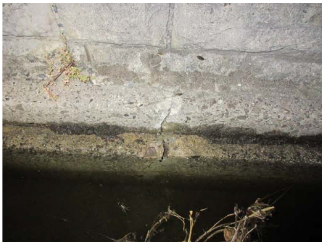
○護岸漏水状況 近景
