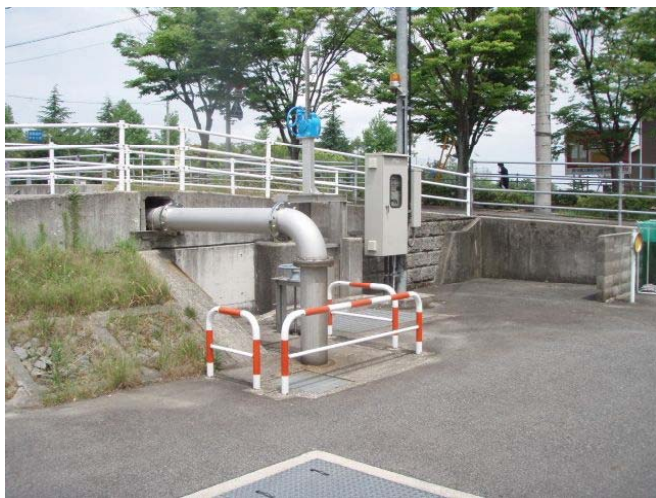
○ポンプ（道路側から見て）
