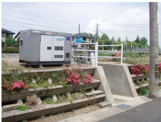
○仮設排水ポンプ（道路側より）
