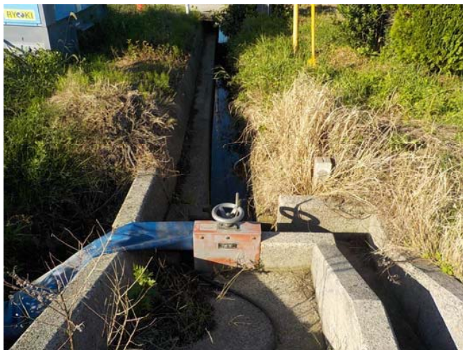
○樋門・仮設排水ポンプ①（中海側より）
