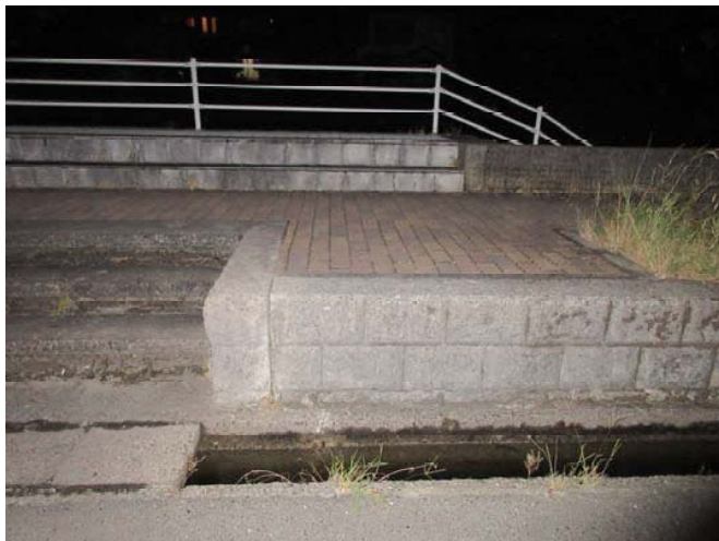
○護岸漏水状況（高潮時）
