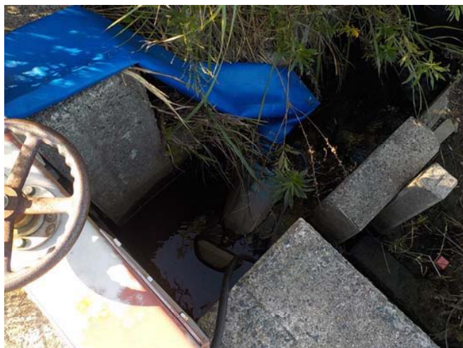
○仮設排水ポンプ②（中海側より）
