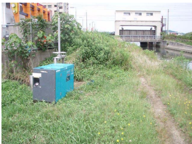
○仮設排水ポンプ
