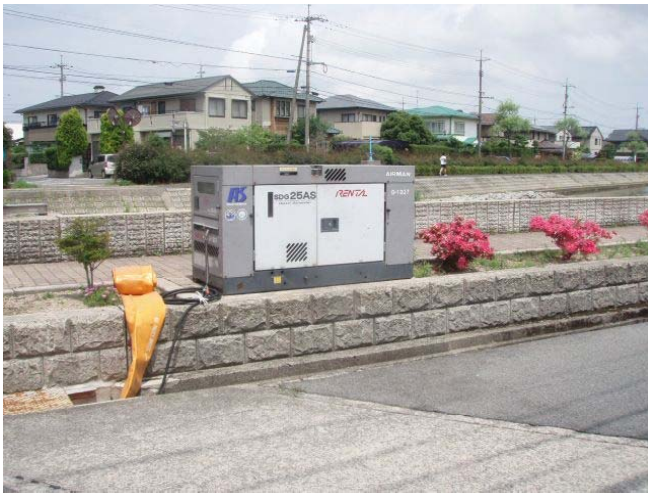
○仮設排水ポンプ（道路側より）
