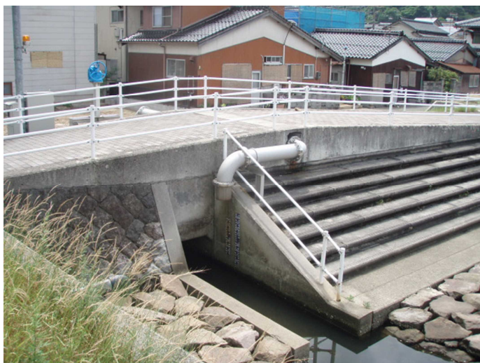
○排水ポンプ（承水路側から見て）
