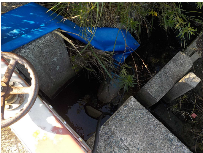
○仮設排水ポンプ②（中海側より）
