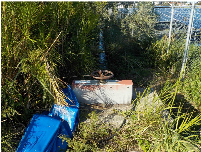
○仮設排水ポンプ②（中海側より）
