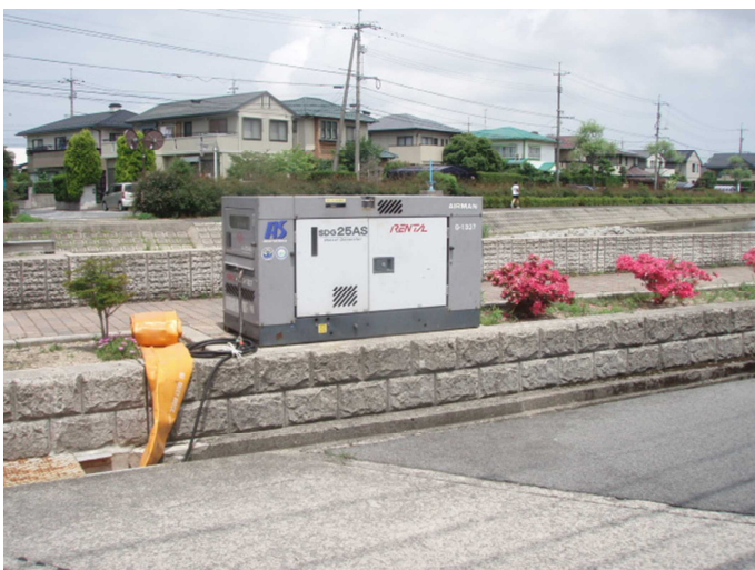
○仮設排水ポンプ②（道路側より）
