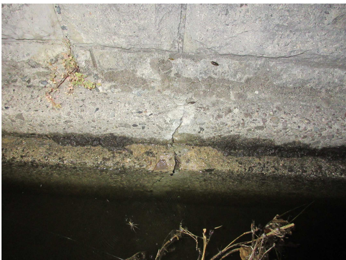
○護岸漏水状況 近景
