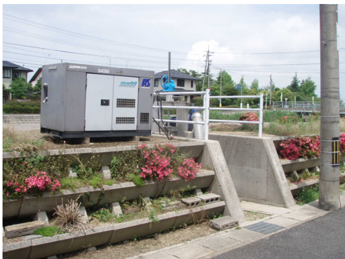
○仮設排水ポンプ①（道路側より）
