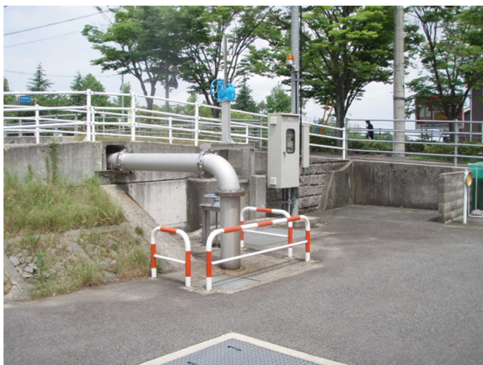
○排水ポンプ（道路側から見て）
