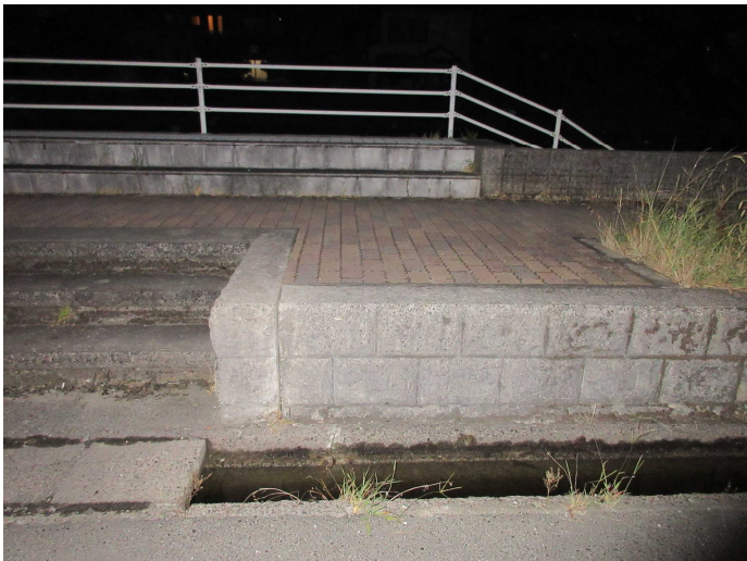
○護岸漏水状況（高潮時）
