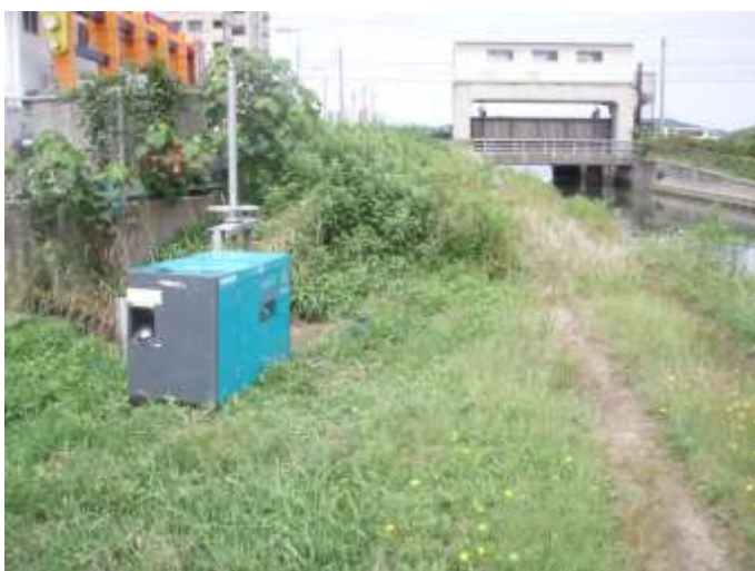
○仮設排水ポンプ
