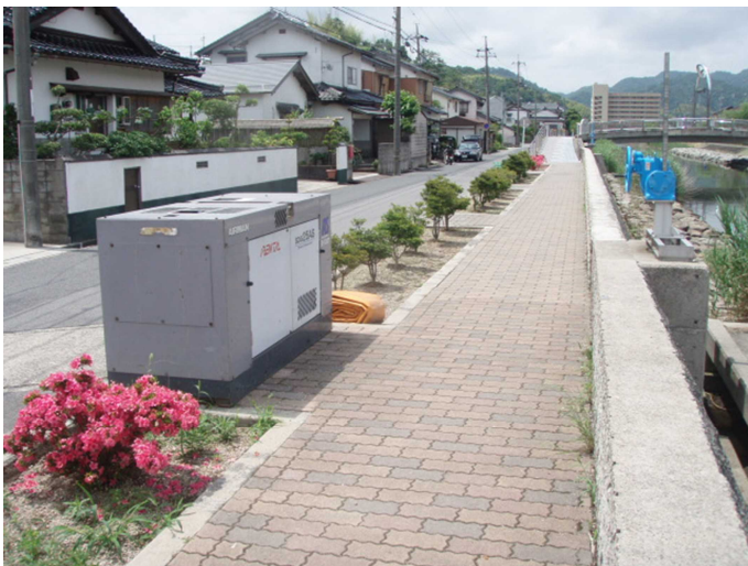
○仮設排水ポンプ②（承水路側より）
