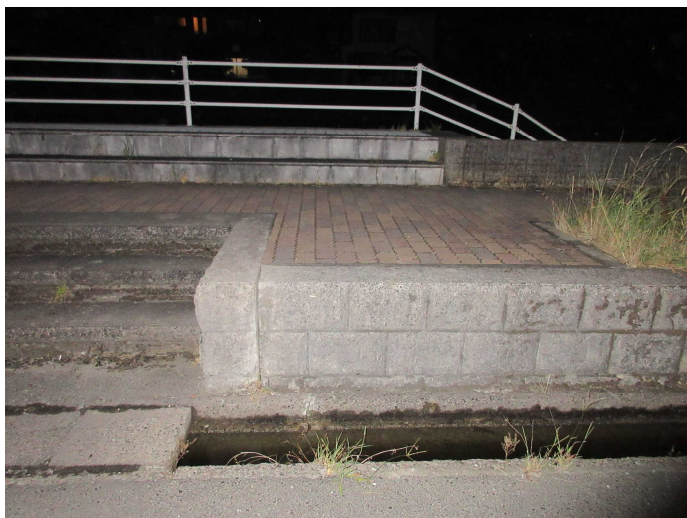
○護岸漏水状況（高潮時）
