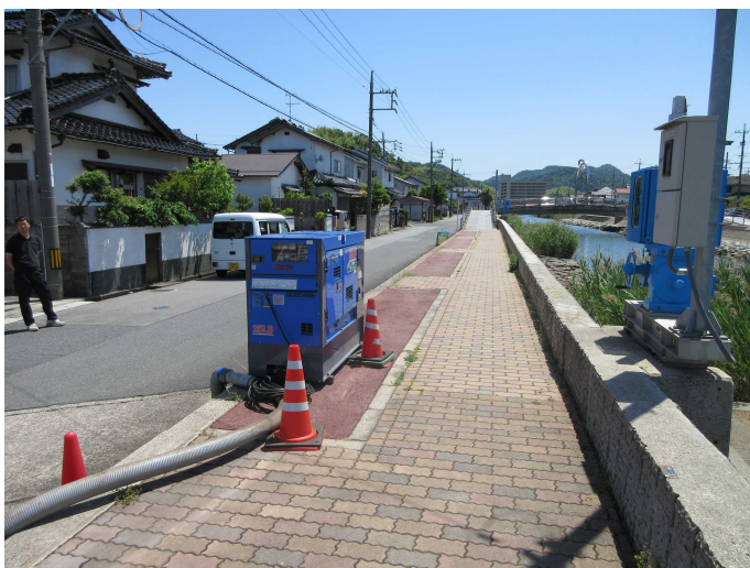
○仮設排水ポンプ②（承水路側より）
