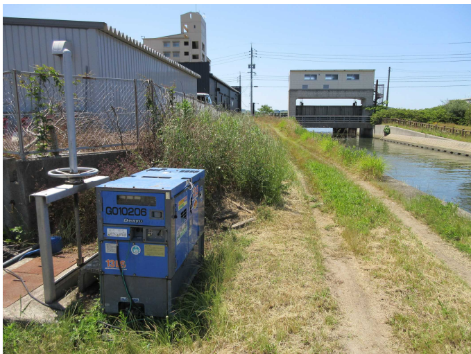
○仮設排水ポンプ
