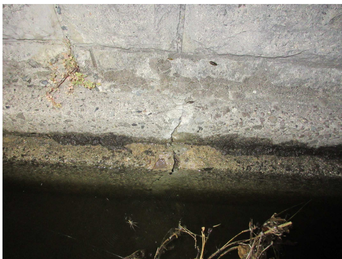
○護岸漏水状況 近景
