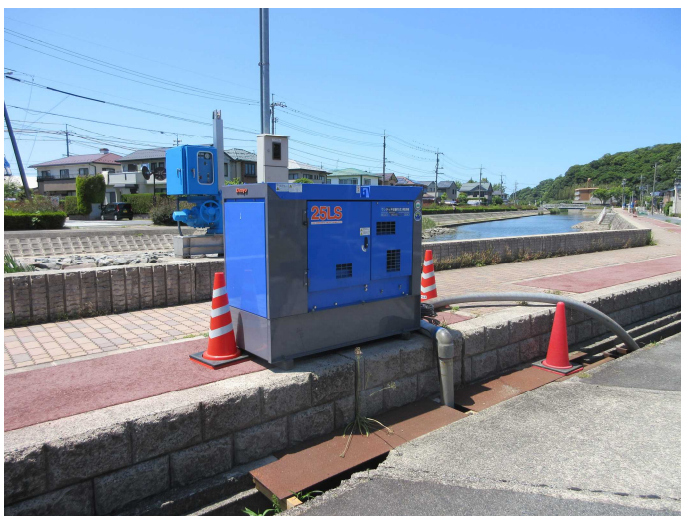
○仮設排水ポンプ②（道路側より）
