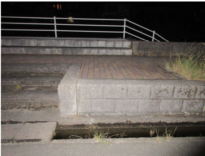
○護岸漏水状況（高潮時）
