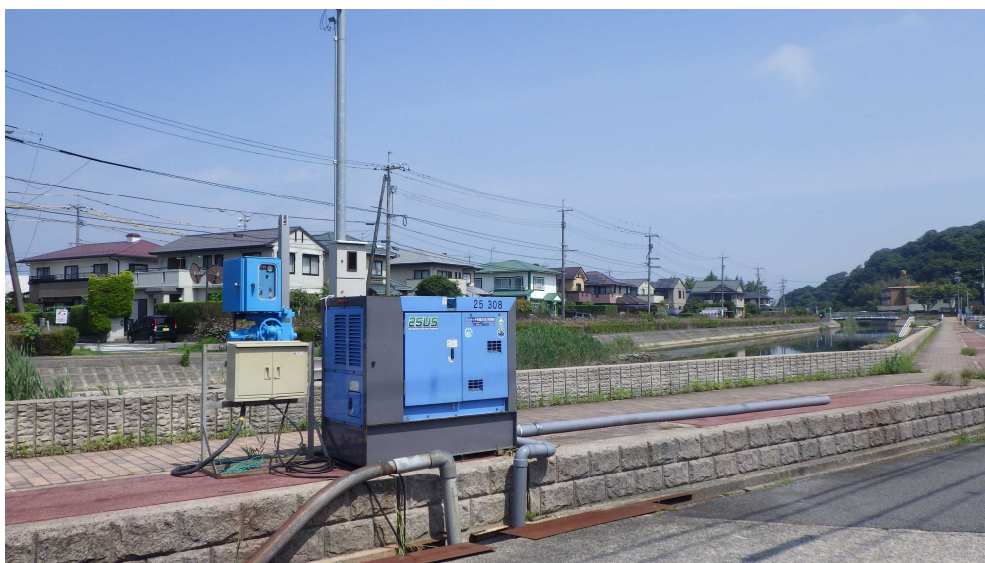
○仮設排水ポンプ②（道路側より）
