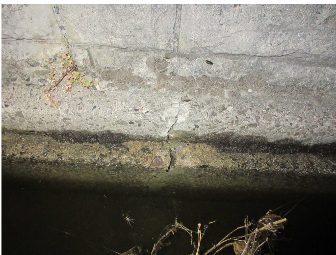
○護岸漏水状況 近景
