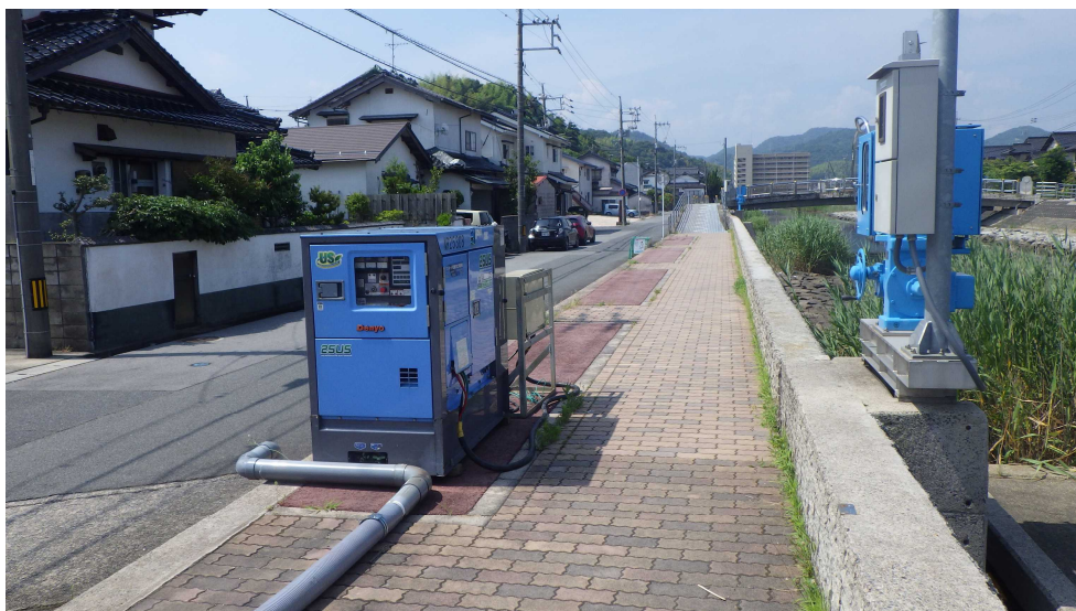
○仮設排水ポンプ②（承水路側より）
