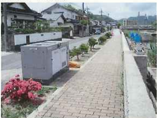
仮設排水ポンプ(北側)
