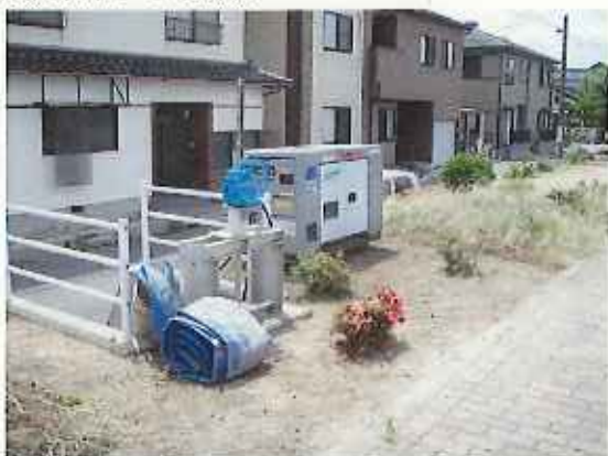
仮設排水ポンプ(北側)
