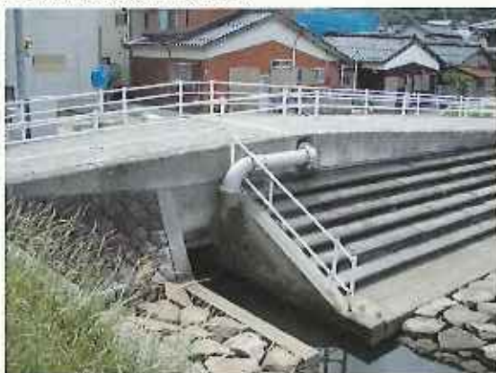
ポンプ(承水路側から見て)
