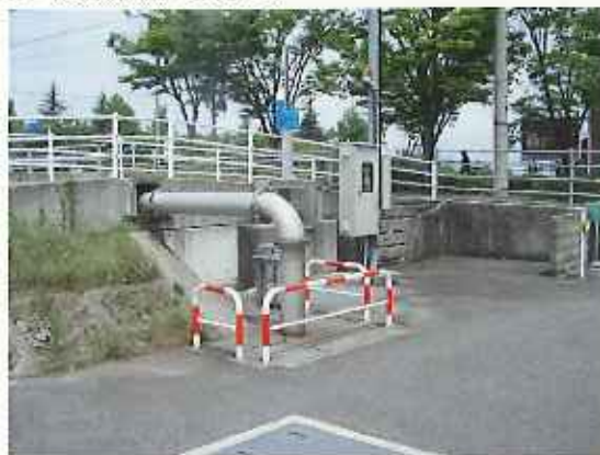
ポンプ(道路側から見て)
