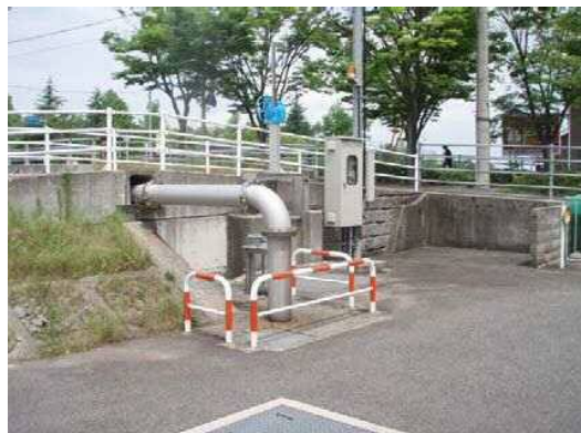
ポンプ(道路側から見て)
