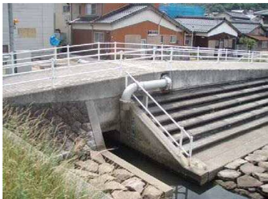
ポンプ(承水路側から見て)
