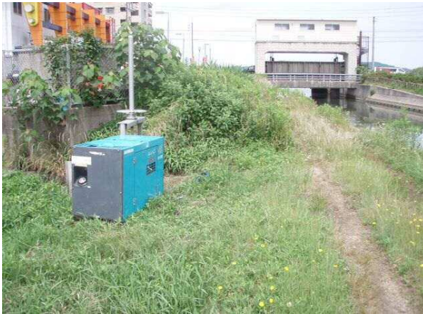
仮設排水ポンプ
