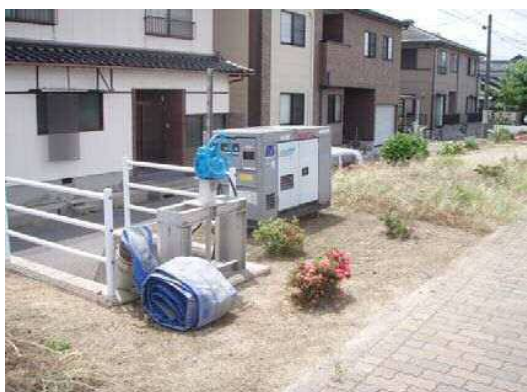
仮設排水ポンプ(北側)
