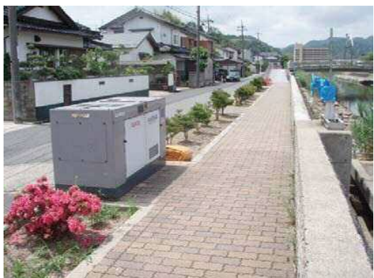
仮設排水ポンプ(北側)
