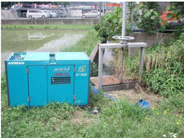
仮設排水ポンプ(北側)
