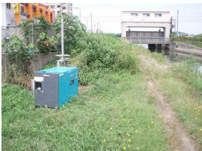
○仮設排水ポンプ
