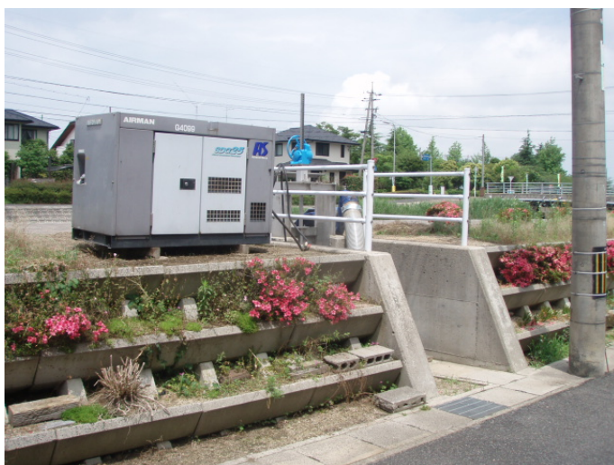
○仮設排水ポンプ（道路側より）
