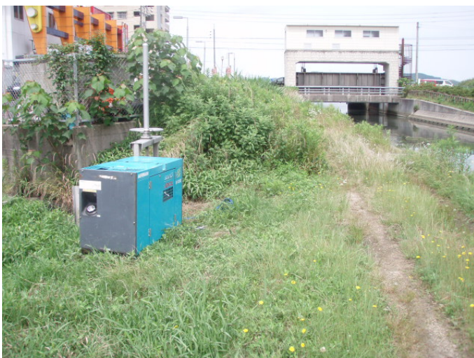
○仮設排水ポンプ
