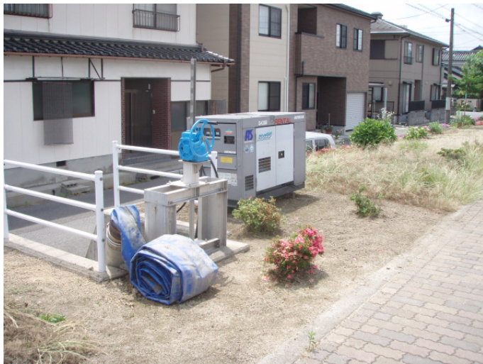
○仮設排水ポンプ（承水路側より）
