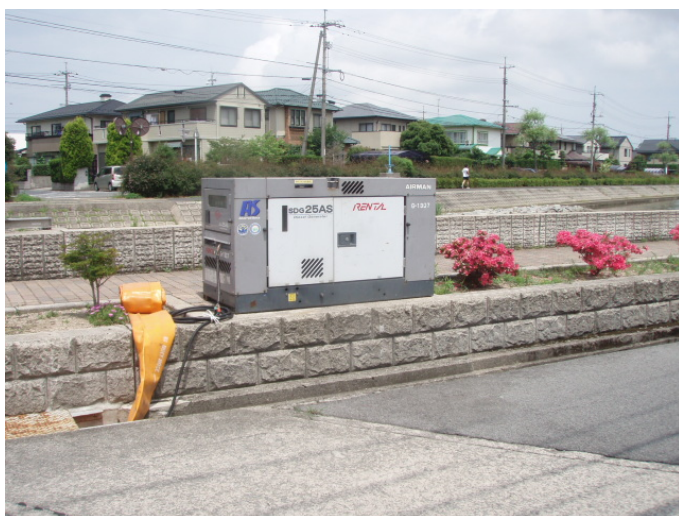
○仮設排水ポンプ（道路側より）
