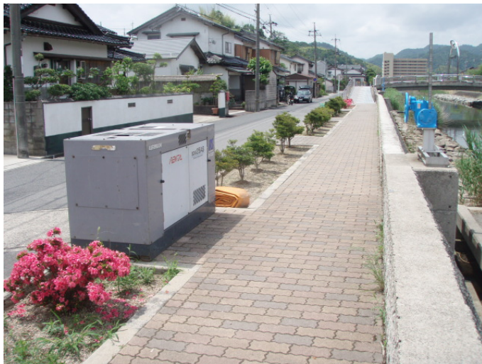
○仮設排水ポンプ（承水路側より）
