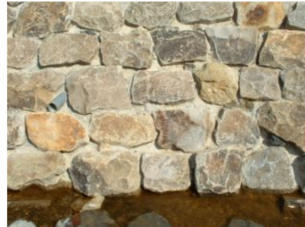
目地コンクリート露出への配慮が欠けた例。石積の力感がなく石張りに見える。
