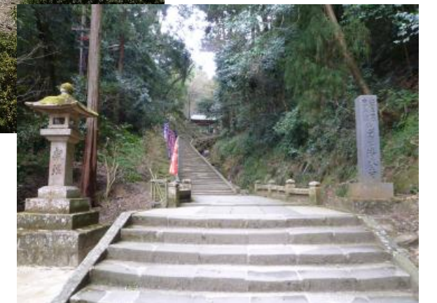
・来待石の切石階段は、神社の石段にも多く用いられてきた。柔らかい材質のため、足当たりが良いとされる。
