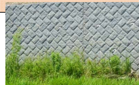
伸縮目地は護岸表面に露出していない状況
