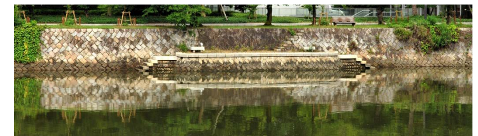
写真8 縦断方向の階段工。階段下にテラスがあることで利用しやすい階段。
