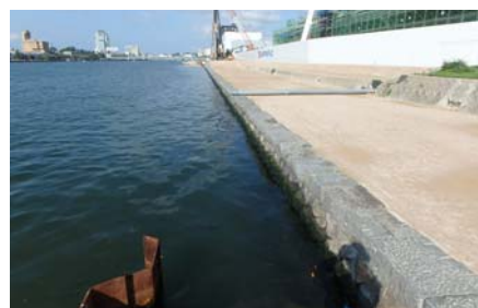
写真3 天端石により天端コンクリートを表面に出さない事例(向島地区)
