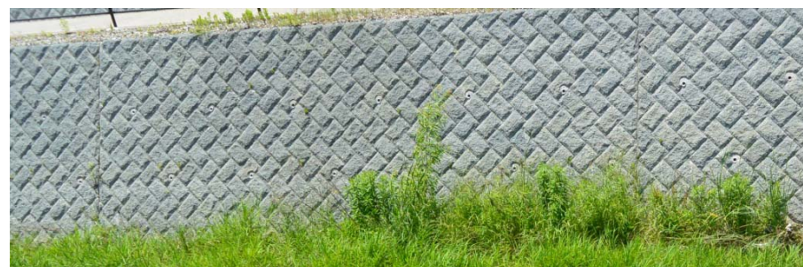
写真6 伸縮目地が護岸表面に露出していない状況。
