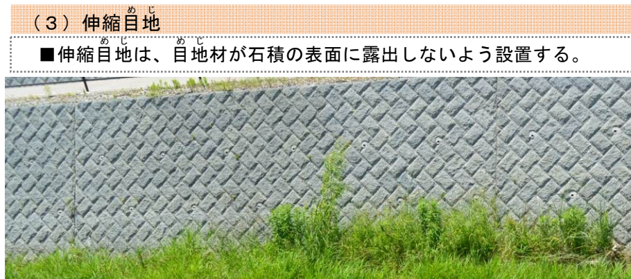
写真7 伸縮目地が護岸表面に露出していない状況。
