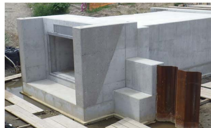
写真9 樋門コンクリート表面を洗い出し処理により明度を落した(福富地区)
