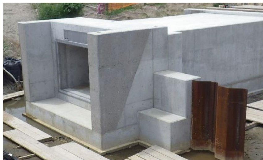
樋門コンクリート表面を洗い出し処理により明度を落した（福富地区）
