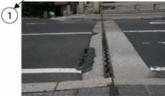
伸縮装置の損傷
