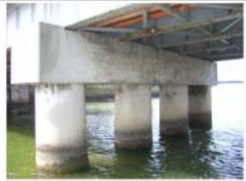
橋脚桁受梁部下面のコンクリートひび割れ状況全景
