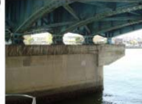
橋脚のひび割れと主桁下面部の錆の発生状況
