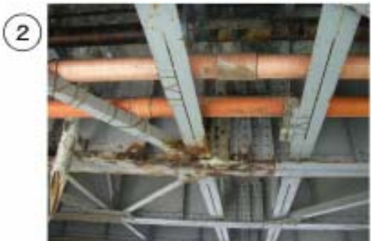
縦ぎ目の腐食状況(北側支間)
