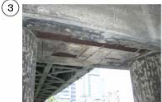
橋脚桁受梁部下面のコンクリート剥離
