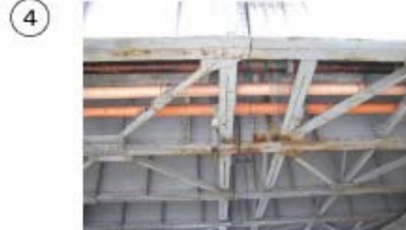
縦ぎ目の腐食状況(中央部)
