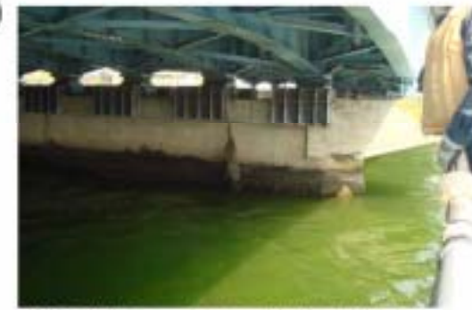
橋脚張出部のコンクリート剥離 欠損(全景)
