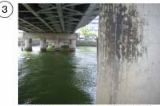
橋脚柱部のコンクリートひび割れと剥離
