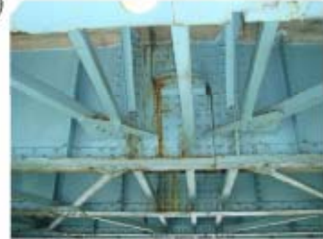
主桁継ぎ目部の錆 腐食状況
