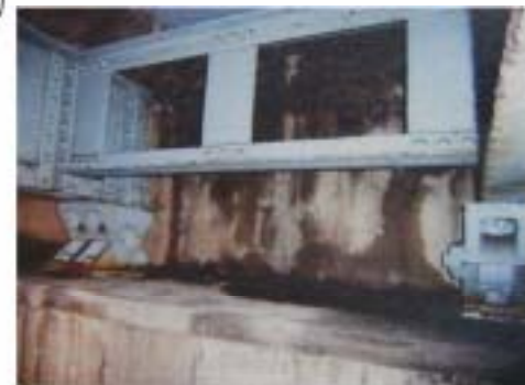
橋台壁部のひび割れ・漏水
