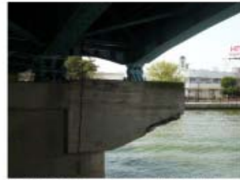
橋脚張出部のコンクリート剥離・欠損
