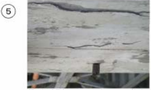
橋脚桁受梁部下面のコンクリートひび割れ
