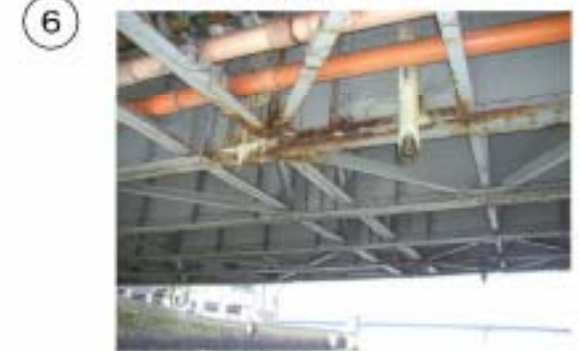
縦ぎ目の腐食状況(南側支間)
