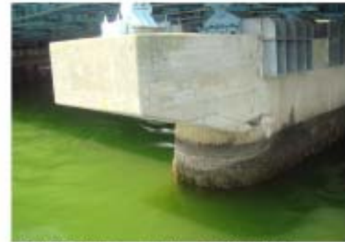
橋脚張出部のコンクリート剥離・欠損
