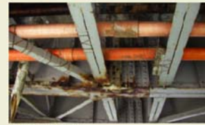
継ぎ目の腐食状況
