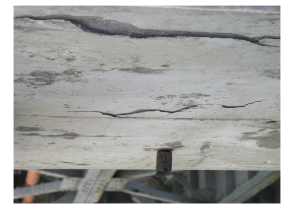
橋脚桁受梁部下面のコンクリートひび割れ
