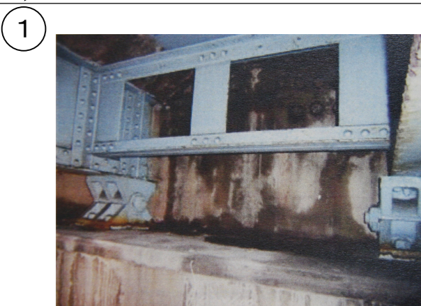
橋台壁部ひび割れ・漏水
