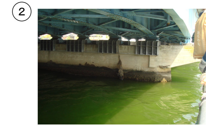
橋脚張出部のコンクリート剥離・欠損(全景)
