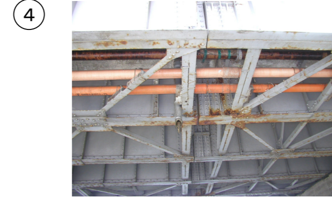
継ぎ目の腐食状況(中央部)
