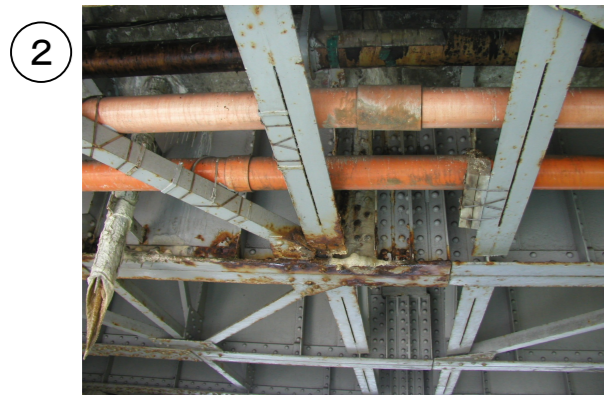
継ぎ目の腐食状況(北側支間)
