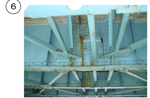
主桁継ぎ目部の錆・腐食状況
