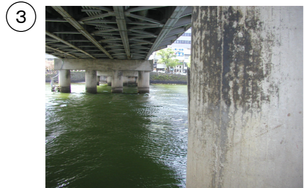
橋脚柱部のコンクリートひび割れと剥離
