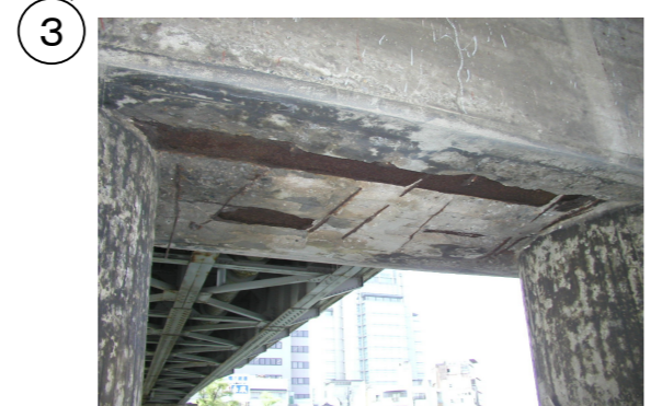
橋脚桁受梁部下面のコンクリート剥離
