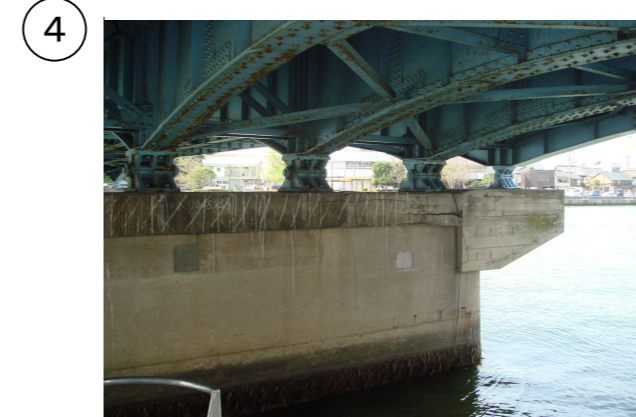
橋脚のひび割れと主桁下面部の錆の発生状況
