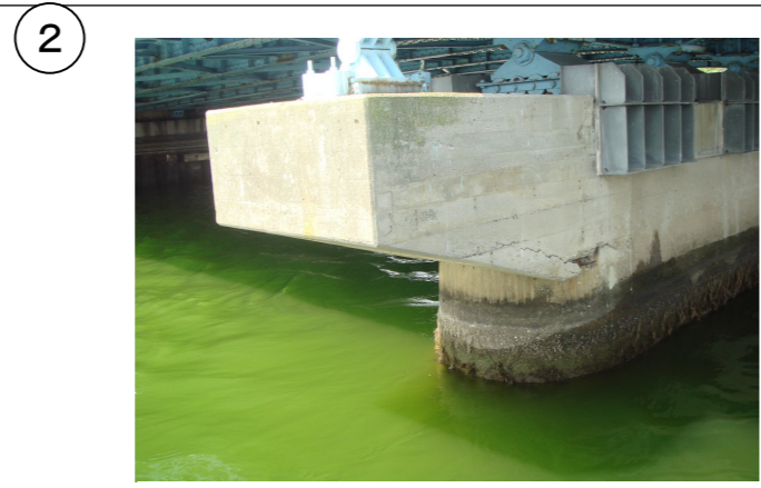
橋脚張出部のコンクリート剥離・欠損
