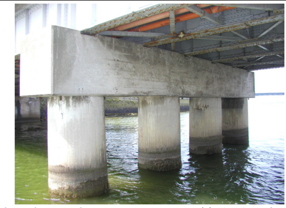
橋脚桁受梁部のコンクリートひび割れ状況全景
