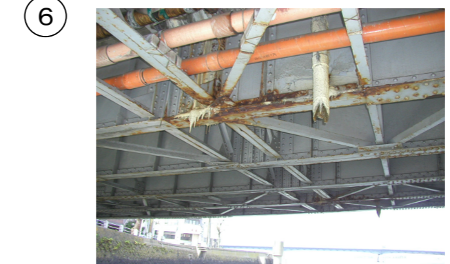
継ぎ目の腐食状況(南側支間)
