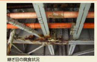
現在の松江大橋の状況（老朽化）
