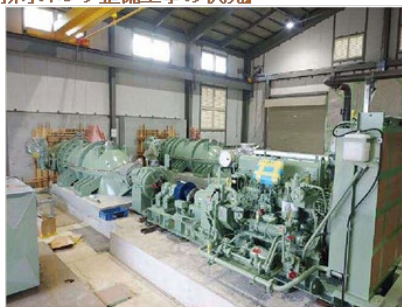
【排水ポンプ整備工場の状況】
