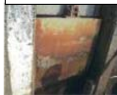
扉体腐食状況
