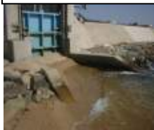
樋門吐口土砂堆積状況
