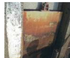
写真 3-2 扉体の発錆及び腐食状況
