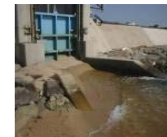
写真 3-3 排水門吐口付近の土砂堆積状況
