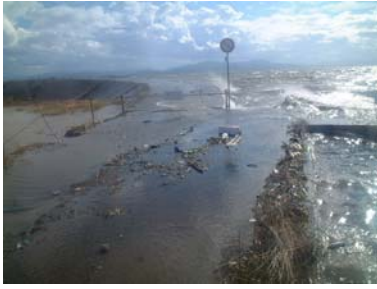
写真 2-5 米子市葭津の浸水状況 (平成 15 年 9 月)
