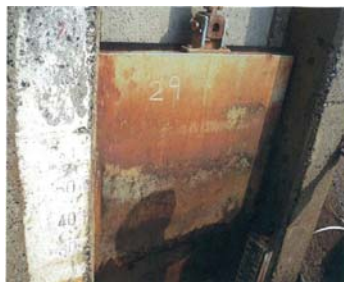
写真 3-2 扉体の発錆及び腐食状況
