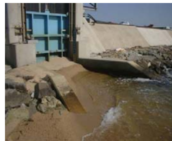
写真 3-3 排水門吐口付近の土砂堆積状況
