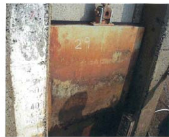
写真 3-2 扉体の発錆及び腐食状況
