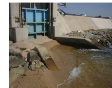
写真 3-3 排水門吐口付近の土砂堆積状況
