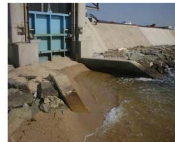
写真 3-3 排水門吐口付近の土砂堆積状況
