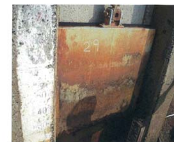
写真 3-2 扉体の発錆及び腐食状況
