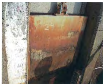
写真 3-2 扉体の発錆及び腐食状況
