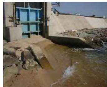
写真 3-3 排水門吐口付近の土砂堆積状況
