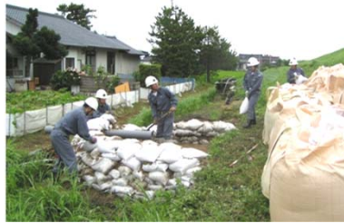
漏水発生による水防活動 (H18年7月)
