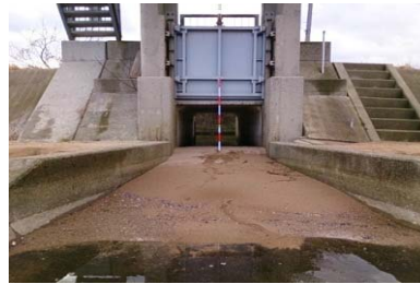
排水門付近に堆積する土砂
