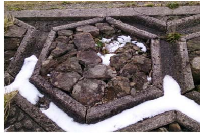
裏石張りの異常
