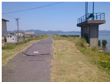
矢道湖西岸の堤防沈下
