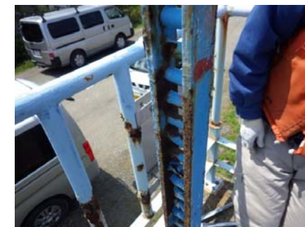
馬淵1号排水門 (開閉装置劣化)
