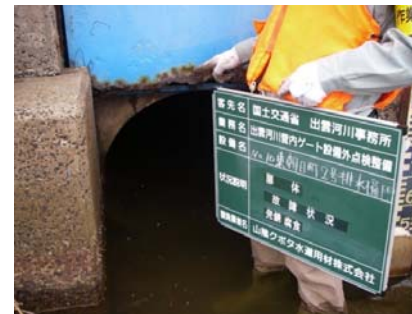
東朝日町2号排水門 (扉体劣化)
