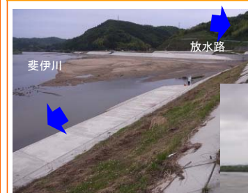
土砂堆積状況
