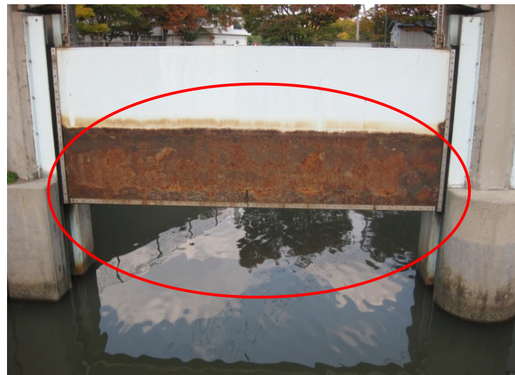
ゲート老朽化による交換が必要(3号ゲート)
