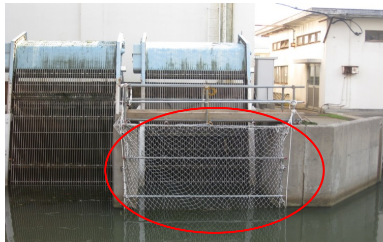
除塵機の故障による仮設の防塵網
