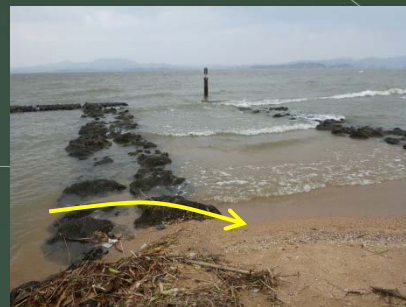
漂砂防止堤の天端を越える土砂
