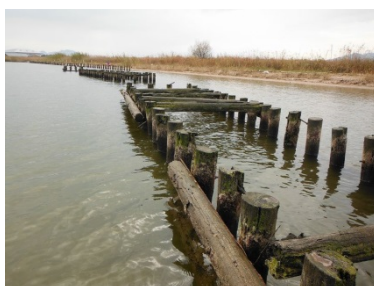
【消波工の損傷】
