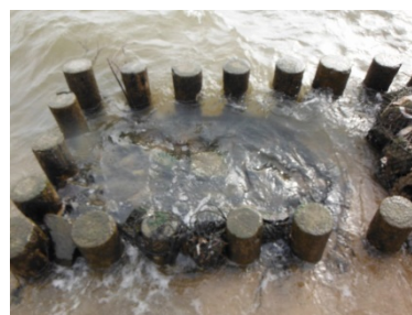
【消波工等の石の中抜け】
