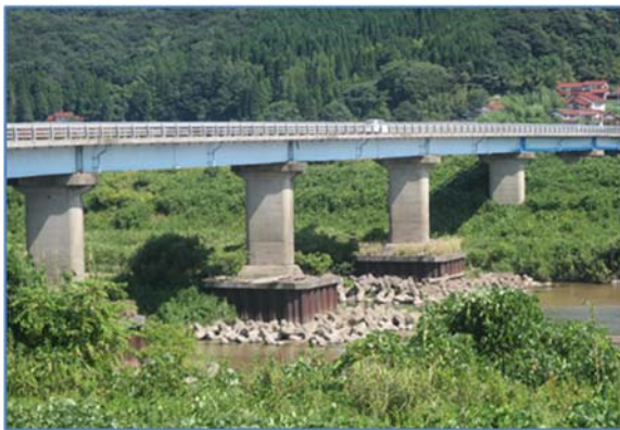
写真－４ 河床低下状況 (斐伊川本川 21k 付近)
