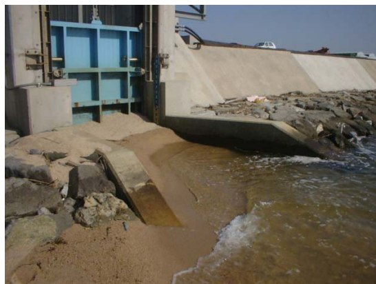
写真－９ 排水門門吐口土砂堆積状況
