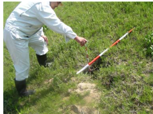
写真－２３ 除草後に確認された変状
