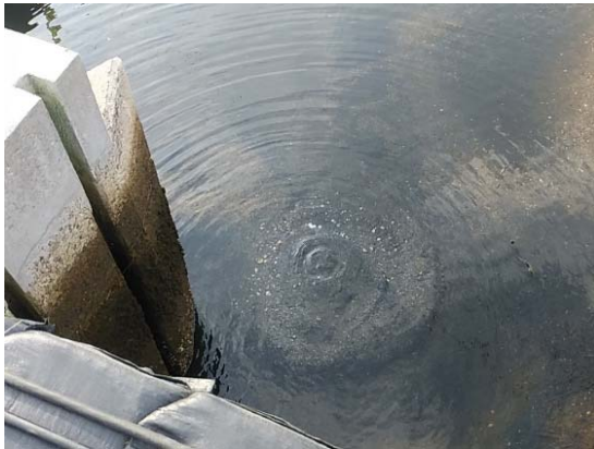
写真－１１ 空洞化による排水門漏水事例
