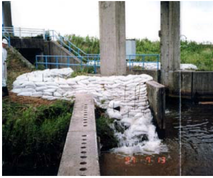
写真－ 1 1 空洞化による樋門漏水事例
