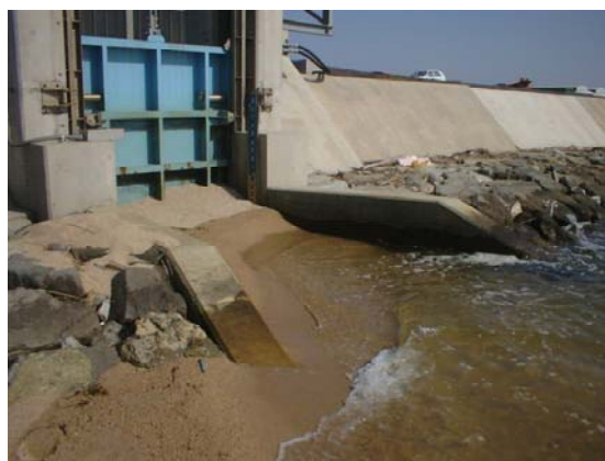
写真-9 樋門吐口土砂堆積状況
