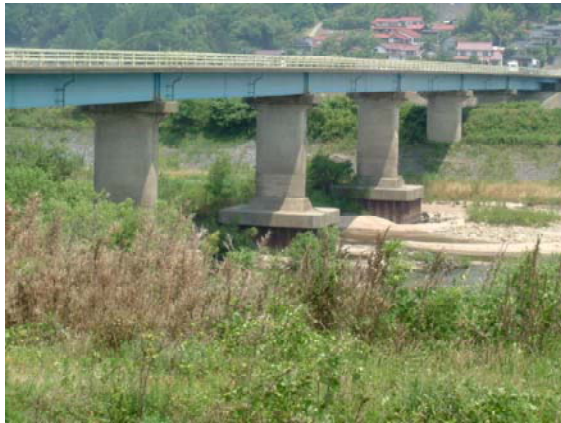
写真－４ 河床低下状況(斐伊川本川 21k 付近)
