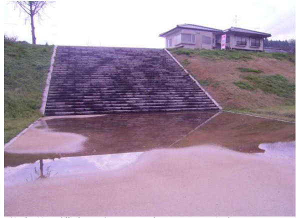
遊歩道の排水不良による水たまりの発生
