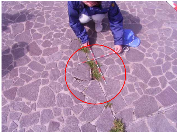
遊歩道石張りの破損
