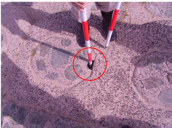
階段護岸のコンクリートブロックに開いた隙間や穴
