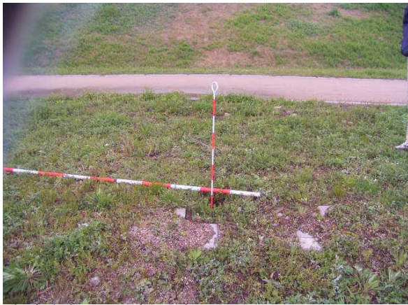
土砂流出による陥没(小)
