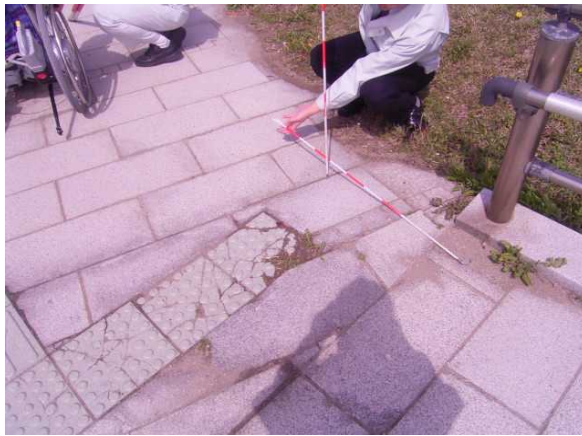
沈下によりできた遊歩道の窪み
