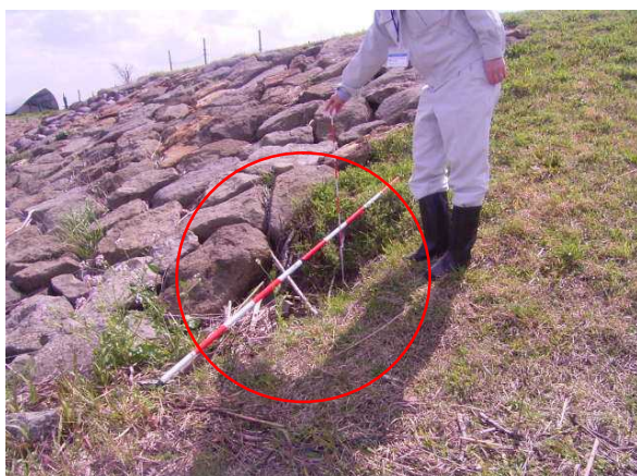
法面の崩れ(小)
