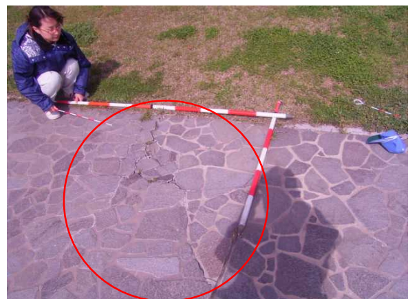
遊歩道石張りの破損(小)
