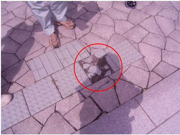
点字ブロックの破損
