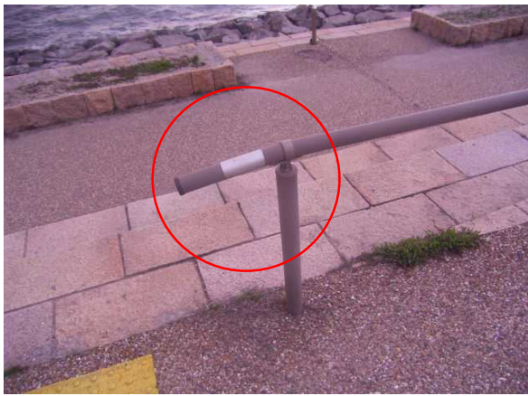
手すりのボルト締め緩み
