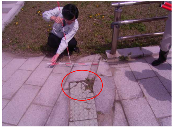
点字ブロックの破損
