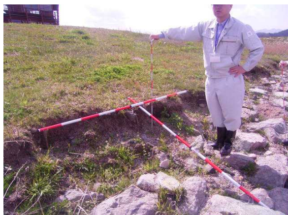
法面の浸食(大)
