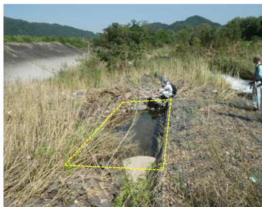
[9月20日 破損状況]
