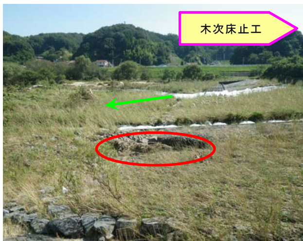
[破損箇所 遠景]
