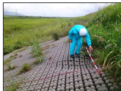
写真 高水護岸の不陸状況
