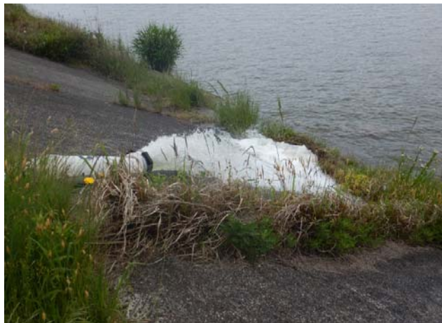
・ 排水ポンプ排水状況
