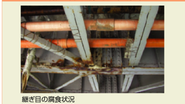
継ぎ目の腐食状況
