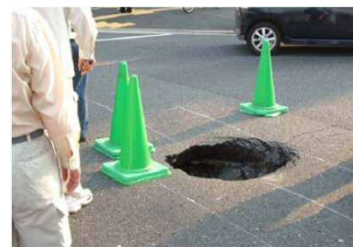
老朽化した下水道管渠腐食に起因する道路陥没状況（広島市中区舟入南） 出典：広島市
