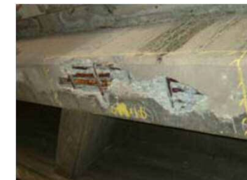
経年劣化及び中性化による主桁コンクリートの剥離及び鉄筋露出 （国道2号 山王橋）
