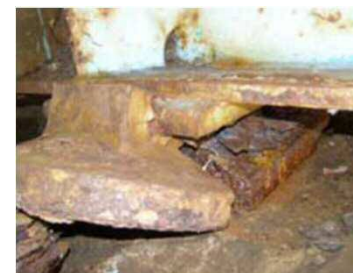
鋼製支承の損傷 （国道29号 須澄橋）
