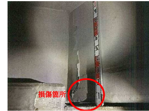
羽合大橋の損傷
