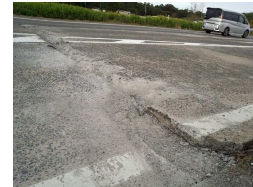
道の駅「北条公園」路面段差
