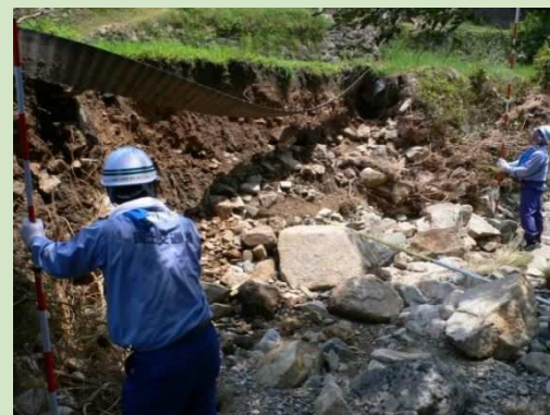
被災状況調査 (広島県福山市)
