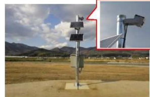
簡易型河川監視カメラの設置例
