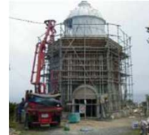
航路標識耐震化
