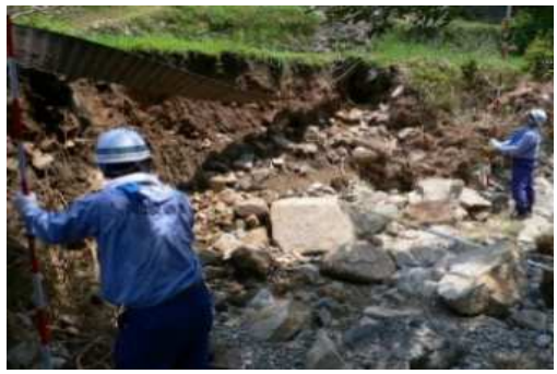
TEC-FORCE派遣による被災状況調査
