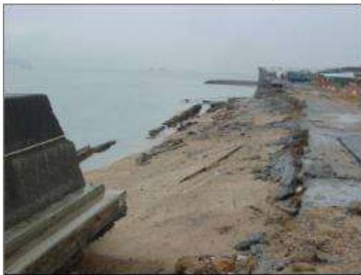
平成16年の台風高潮による護岸崩壊
