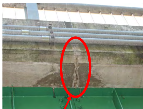
桁のひび割れ
