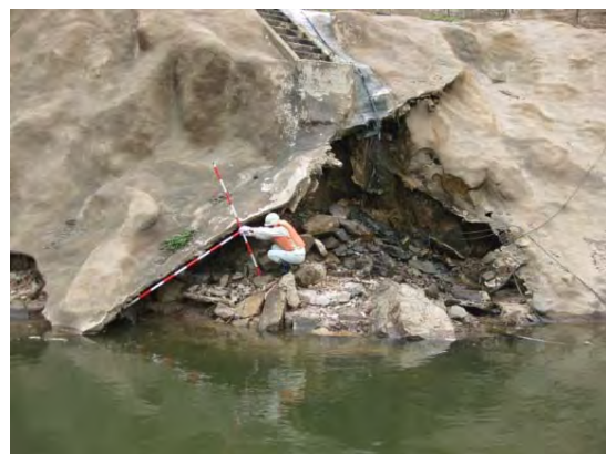
モルタル吹き付け背面空洞化（遠景）
