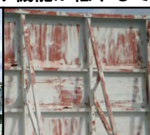
腐食したゲート
