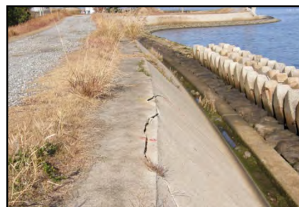
老朽化により亀裂の入っている護岸
