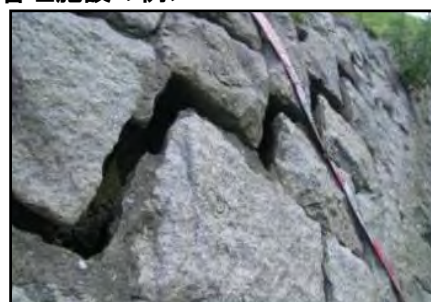
経年的な沈下で機能低下した護岸
