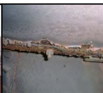
除塵機内部の腐食状況
