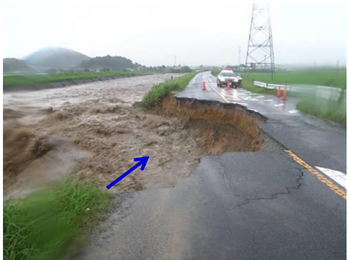
堰の流失時に侵食された堤防
