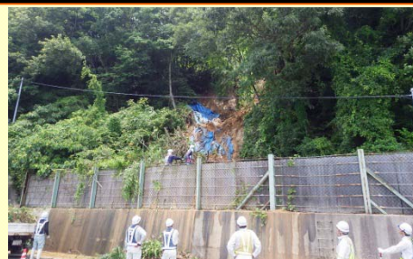
法面崩落箇所の対策検討（竹原市）
