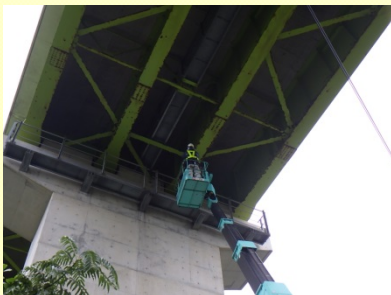
橋梁緊急点検（湯梨浜町）
