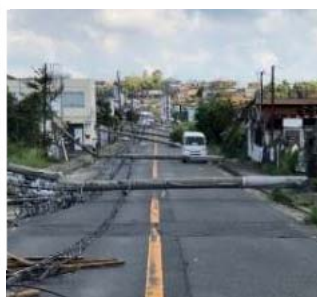
<電柱の倒壊による道路閉塞の事例>
