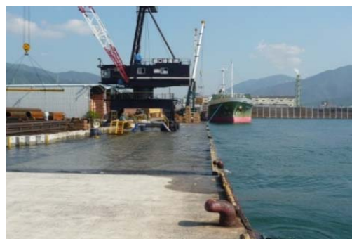
岸壁の沈下による浸水状況
