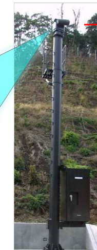
CCTVカメラ装置
