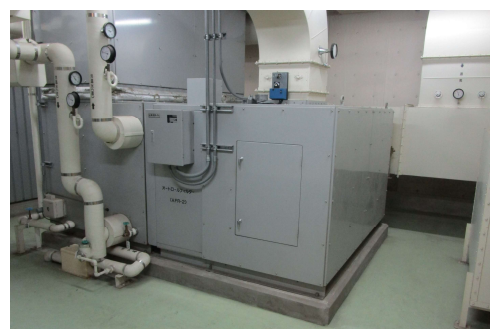
現況写真(機械設備)
