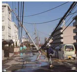
<飛来物による電柱倒壊の事例>
