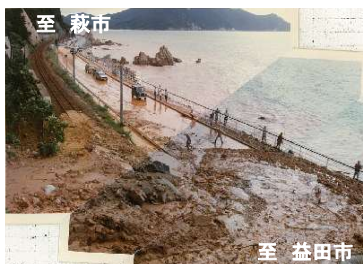
【写真②】S55年土砂崩壊の状況
