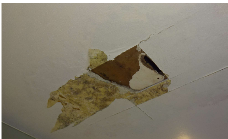
現況写真(漏水)
