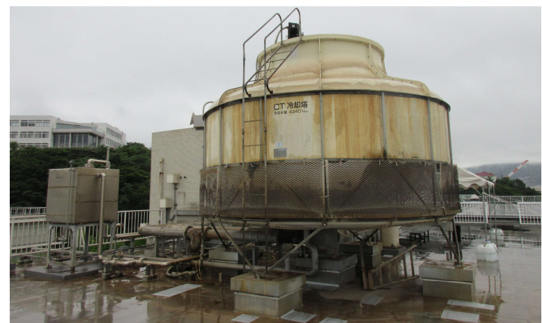
現況写真(冷却塔)
