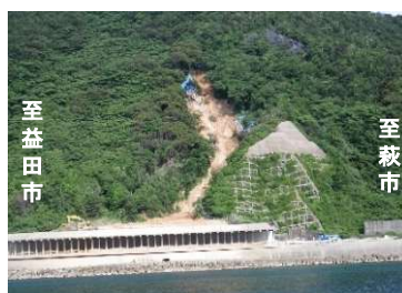
【写真③】H23年土砂崩壊の状況
