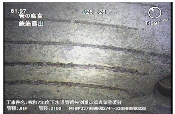
調査により判明した腐食箇所
