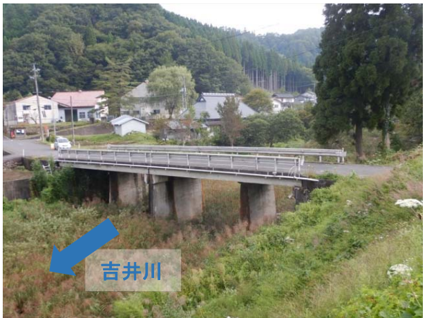
被災前の状況
