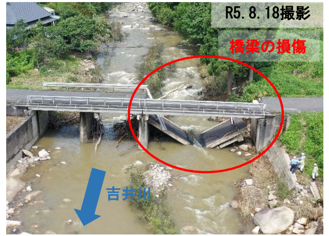
被災後の状況
