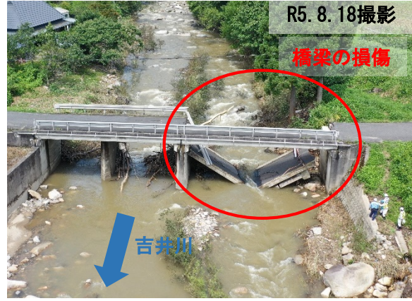
被災後の状況
